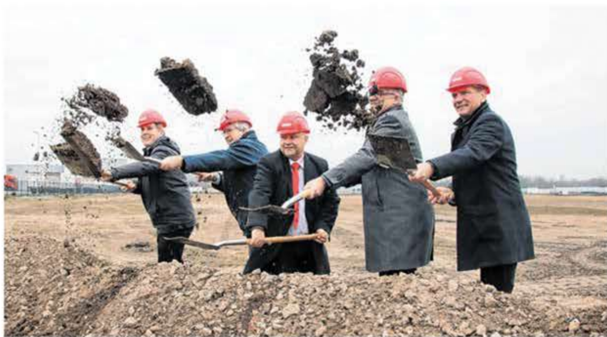
Symbolischer Akt: Alexander Laesicke, Jörg Steinbach, Torsten Prag, Uwe Feiler und Stefan Hörning (v.r.) greifen zum Spaten und geben den Startschuss für das Baugeschehen. Fotos (3): Klaus D. Grote
